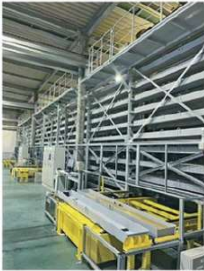
本稼働した黄銅棒用立体自動倉庫
